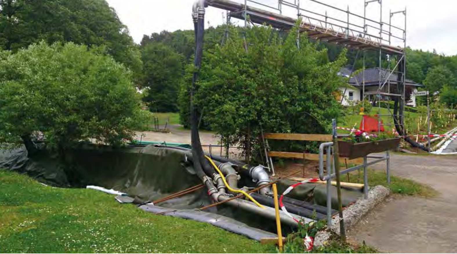
Vor der Einleitung in die Losse werden aus der Brunnengalerie Losseae in Absetzbehältern die Schwebstoffe aus dem Wasser abgeschieden. Fotos (2): RP/Marc Eidam
