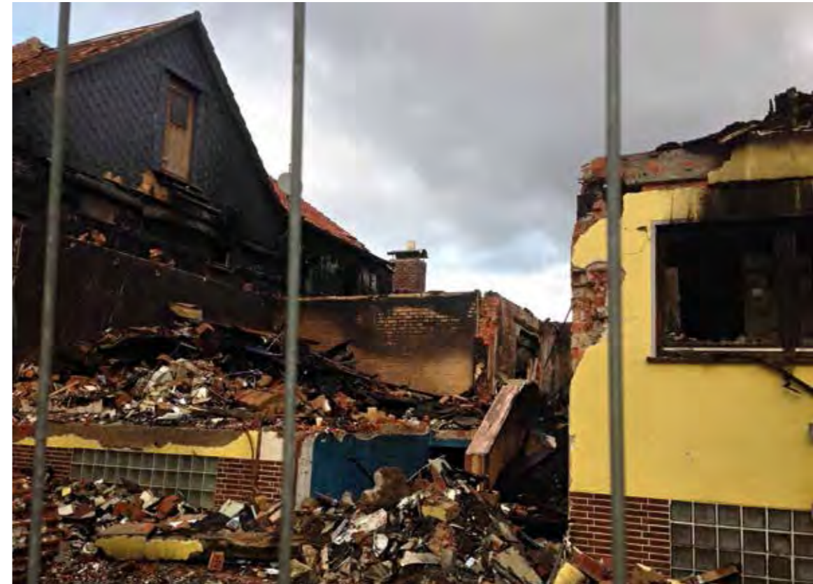
Nicht nur bei geplantem Abriss und Neubau muss es um die sichere Entsorgung kritischer Bauabfälle und die Weiterverwertung von Rohstoffen gehen. Auch dort, wo Brändruinen zu beseitigen sind, achten die Abfallxperten vom RP darauf, dass dies qualifiziert geschieht. Foto: RP
