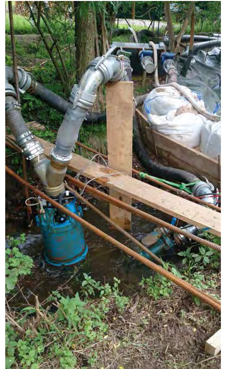
Die Pumpe und der Fangedamm im Steinbach. Sie halten den Gewässerabschnitt trocken, während dort die Dichtungsbahn verlegt wird.
