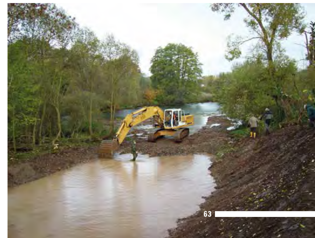
Ein Blick auf die Eder bei Berkheim vor etwas mehr als einem Jahr, bevor Flora und Fauna die ehemalige Baustelle zurückerobern konnten. Die Arbeiten sind fast beendet, und das sogenannte Nebengerinne wird gerade an die Eder angeschlossen. Foto: RP
