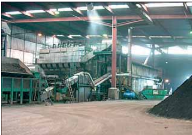
Abb. 5.42: Thermische Bodenbehandlungsanlage Deutzen
