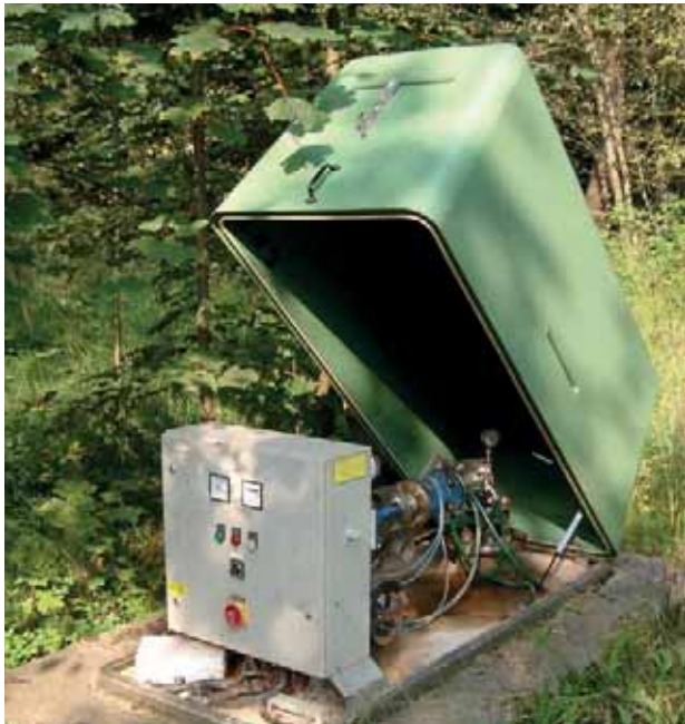
Abb. 5.46: Brunnenkopf unter Brechtelhaube (Wetterschutz)
