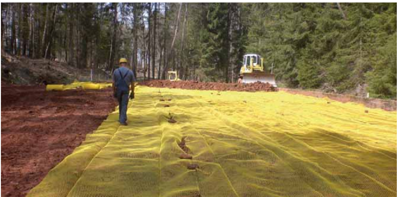
Abb. 5.37: Übererdung SB 14d (Mononitrierung)
