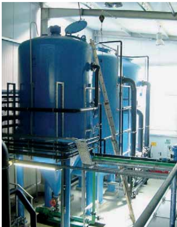
Abb. 5.3: Blick in die Wasseraufbereitungsanlage
