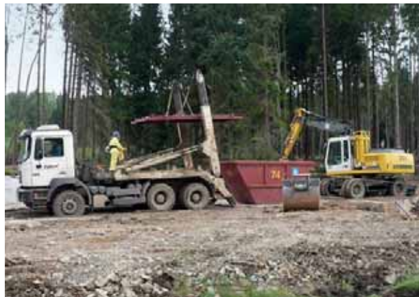
Abb. 5.39: Container, die gasdicht verschlossen werden können
